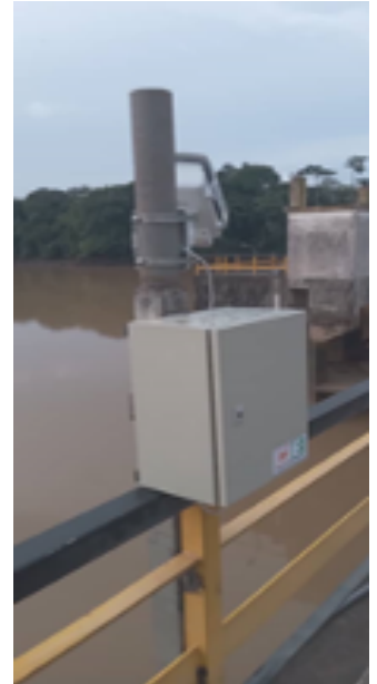
Sensor de nível de água em barragem hidroelétrica
