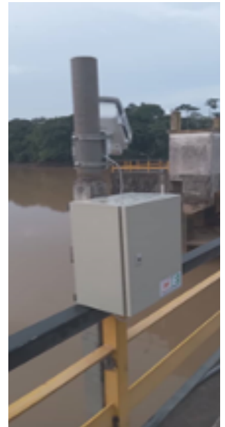
Sensor de nivel de agua en una presa hidroeléctrica
